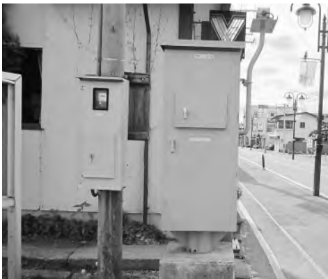
奥山医院前消雪ポンプ設備（操作板）
