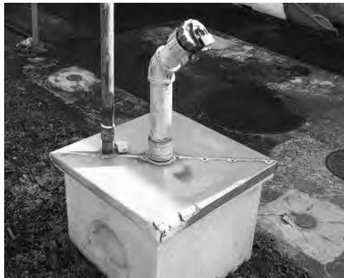
柏陵荘 灯油タンク注入口
