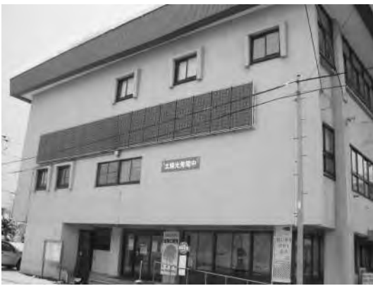
真室川役場に設置されている太陽光パネル
