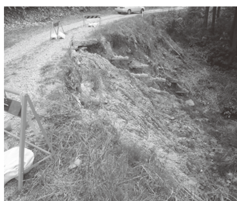
路肩崩落した小新・楯山線
