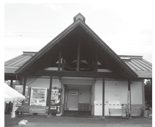
道の駅おおえに設置される急速充電装置
