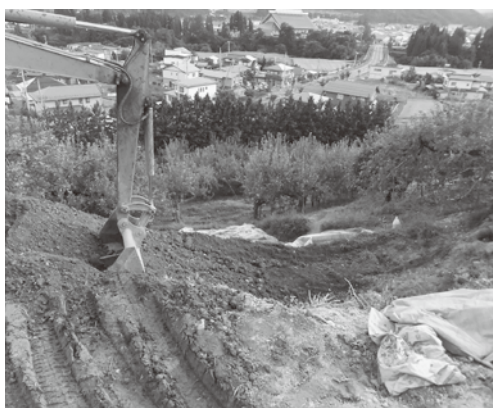
土砂崩落した果樹園 (蛭水団地北側)
