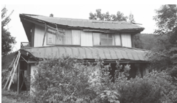
豪雪で壊れた空家
