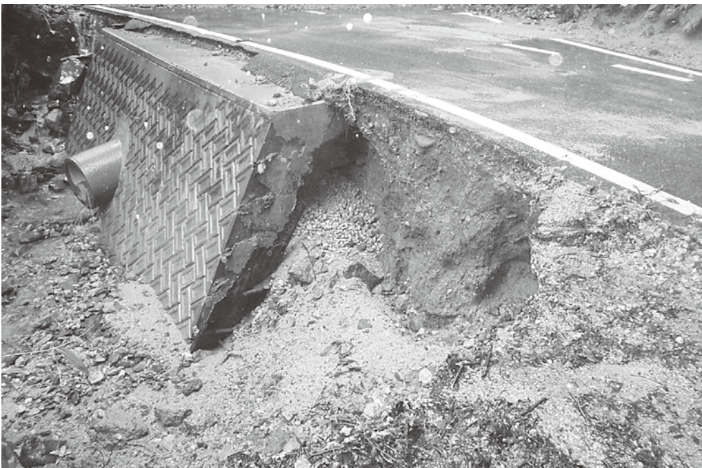
古寺神通峡線の被災現場
