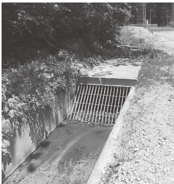
土砂や流木が詰まる暗渠入口の鉄柵
