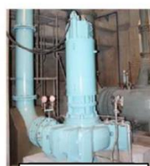
設備機械の防水化 (耐水型モーター)
