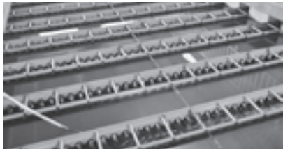
傾斜版沈殿池…泥の粒を沈殿させ除去し、きれいな上澄み部分を抽出する
