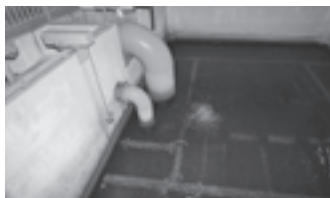
急速ろ過池…細かい砂と大きな砂利を通して更に浄化
