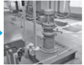
薬品混和地…凝集剤を入れかき混ぜる
