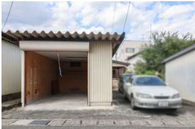
↑シャッターは手動です。壁に二か所凹み有り
