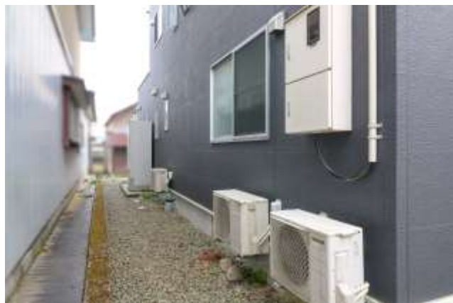
↑壁面にエコキュートが設置してあります。
