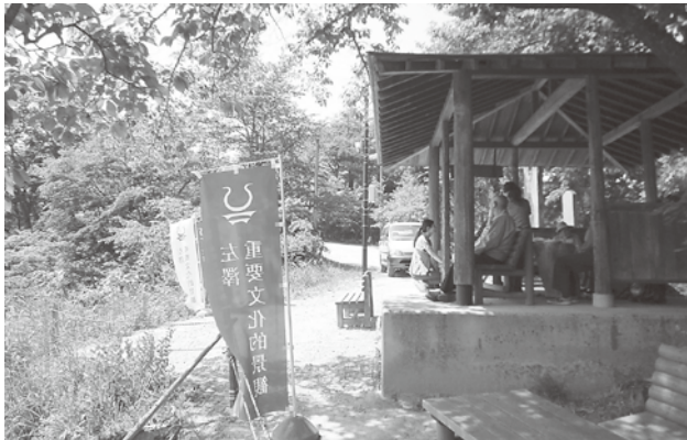
雨水により地盤侵食が進む日本一公園の楯山亭
