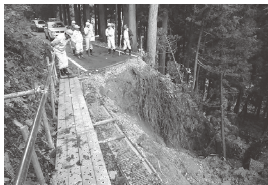
神通峡連絡線 2か所 道路崩壊 平成26年8月・11月完成予定
