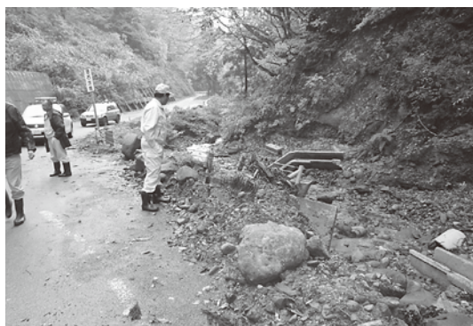
大江西川線 路肩決壊・路面流出 平成26年度中に復旧工事完成予定
