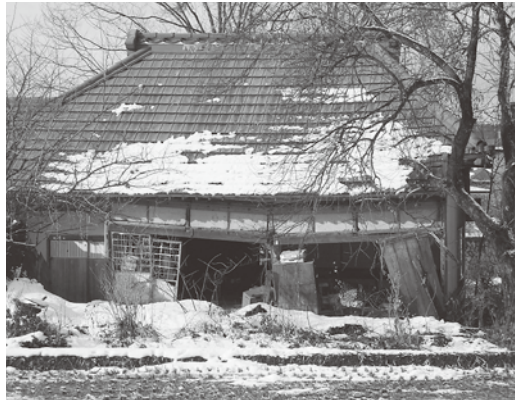
倒壊寸前の空き家
