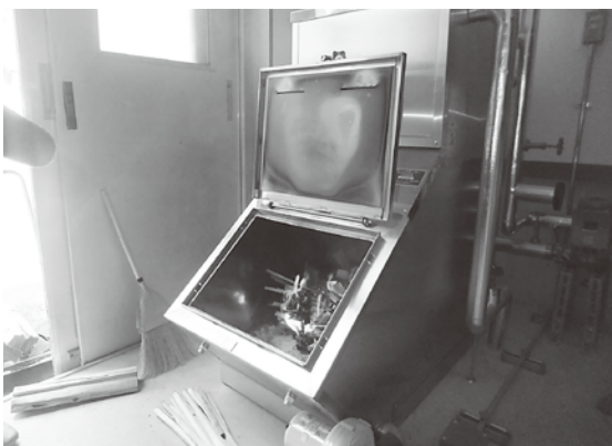
森林資源を活用した薪ボイラー
