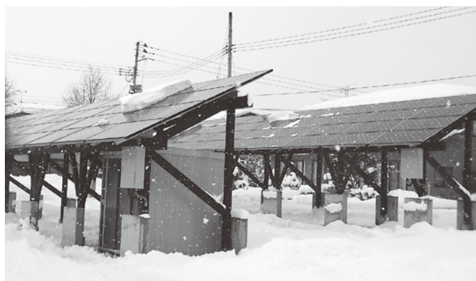
体育センター駐輪場の太陽光パネル
