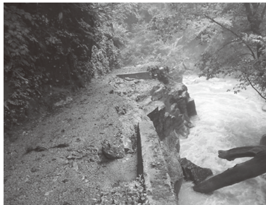
観光拠点として早期復旧が望まれる神通峡の歩道
