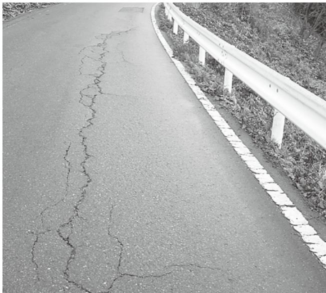
補修工事が待たれる路線
