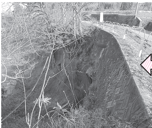
月布川に面した危険な崖崩れ (町道十八才旧道線工事予定地)
