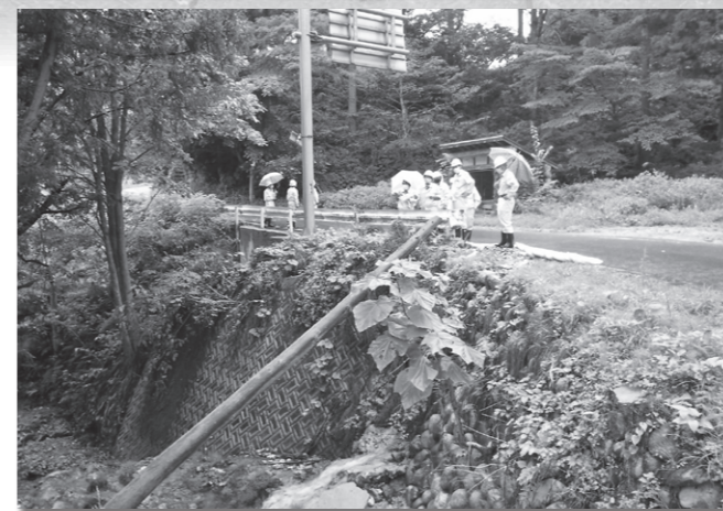
沢口地区の災害現場
