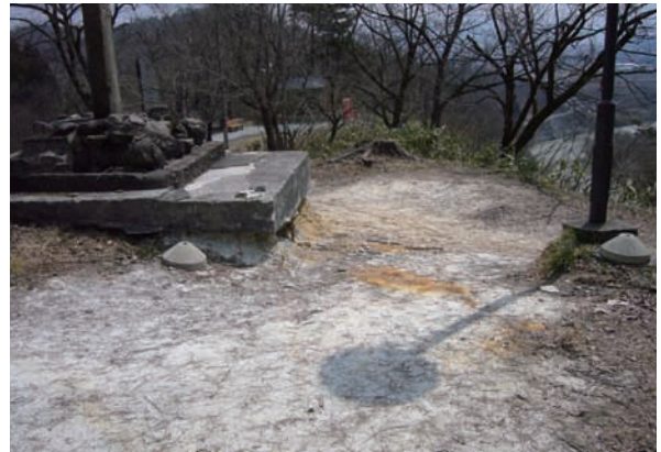
地山の露出と土の流出（建築物の基礎が露出している 楯山公園）
