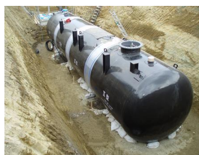
非常用飲料水貯水槽
