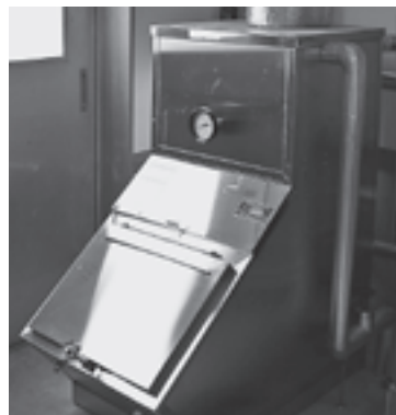
▲山里交流館に設置された薪ボイラー
