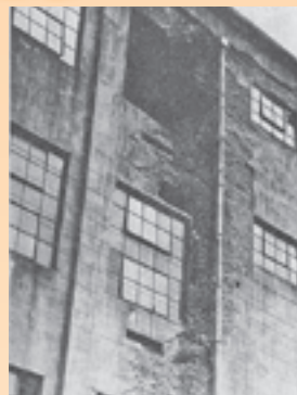
▲左沢地震で被害を受けた旧左沢小学校校舎
